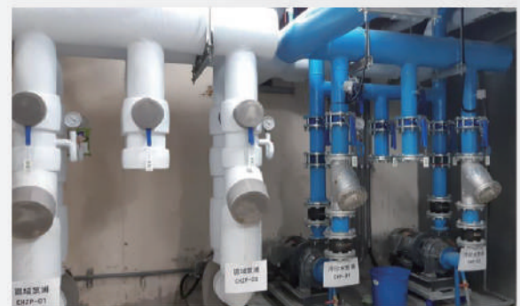
■ 公館校區圖書館中央空調汰換
